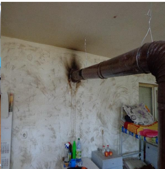
Следи от опушване по стените
