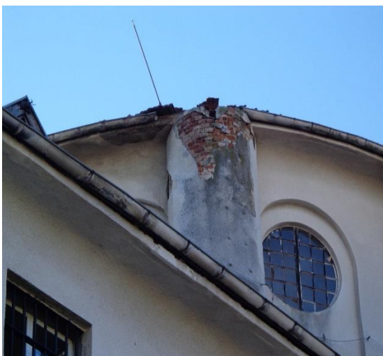
Изглед отвън на рушащата се мазилка
