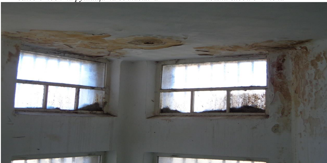
Следи от теча на покрива
